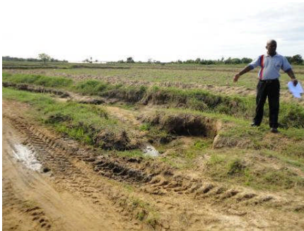
荒廃し、機能しなくなった排水溝(修復前)
